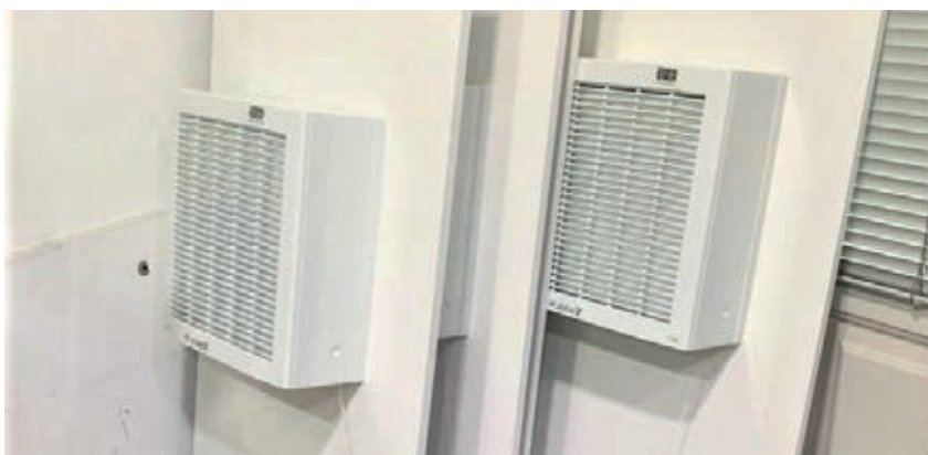
Extractores de renovación de CO2 instalados en las aulas de los colegios.
