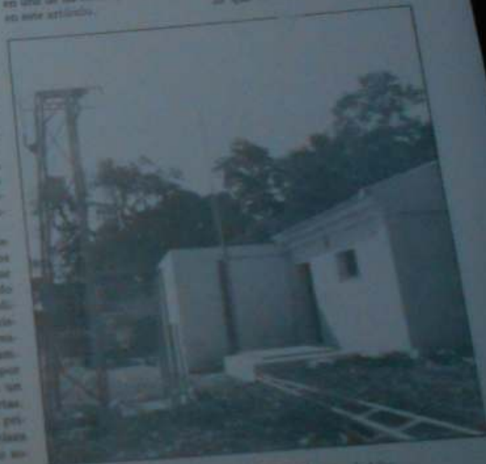
Casa de mando y control de la zona de Lijar
